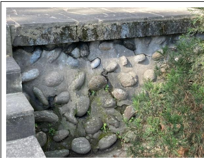
圖 24 神社本殿壘石基座開裂
