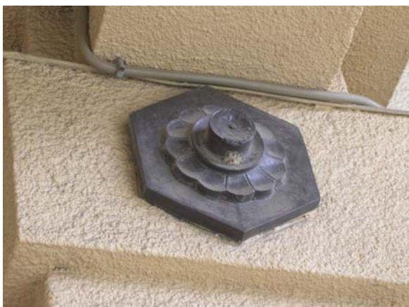
修復前：壁面 FRP 六角菊花飾。拍攝於 2006 年 2 月
