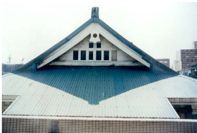
北面龜甲懸魚現況
