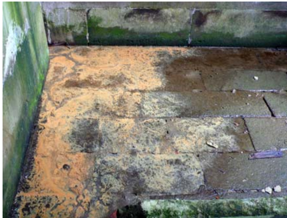
排水不良易造成地坪阻塞積水
