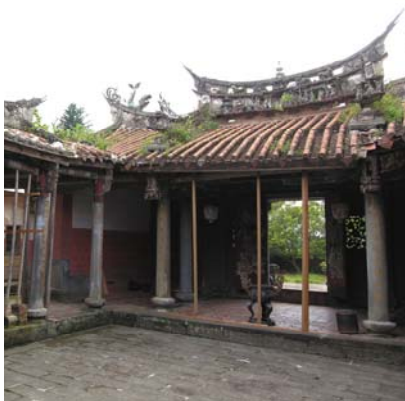
屋面坍塌變形、雜草蔓生
