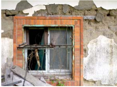
由牆面至牆體受損狀況
