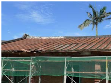
屋面沉陷、屋瓦滑脫
