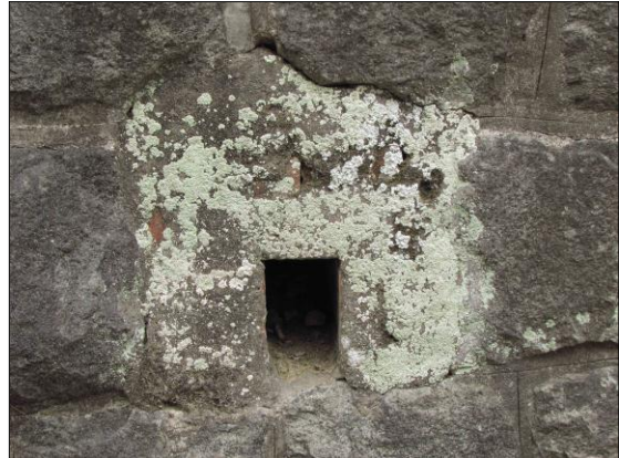
圖 7-170 砲座(1)左側排水孔
