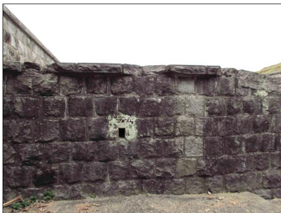
圖 7-171 砲座(1)左側排水孔
