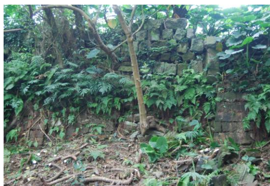
照片 3-2-21 填實後的樓梯已經崩塌
