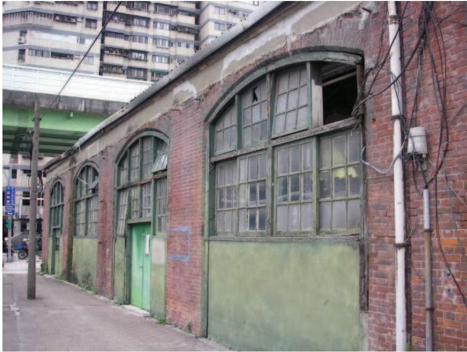
圖 2-19 鐵路局舊禮堂西側立面，圖中窗孔於日治時期時曾作為鐵道部台北工場車輛軌道使用，本研究拍攝。
