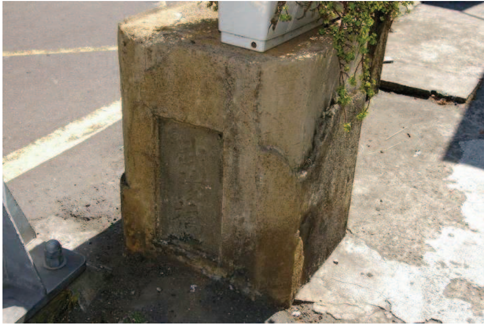
圖 2-63 日治時期「武陵橋」之欄杆橋名柱牌額題字，該橋為 RCT 桁橋構造，目前僅存北側欄杆，本研究拍攝。
