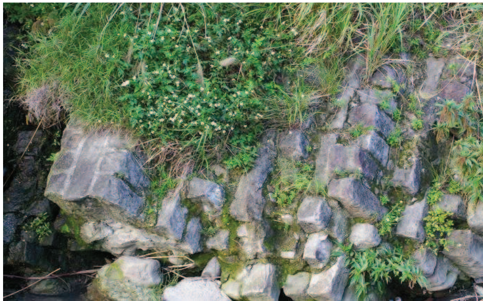
圖 2-36 清末台北至新竹段鐵路「九芎坑橋」遺址南側掉落坡坎之細部，圖中可以看到當時坡坎構築方式採「丁順砌」砌置，本研究拍攝。
