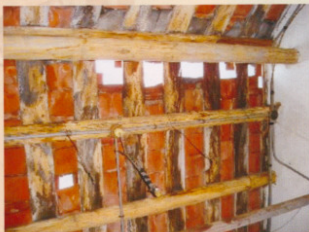
▲圖六十二：左內橫屋屋頂屋瓦缺漏情形
