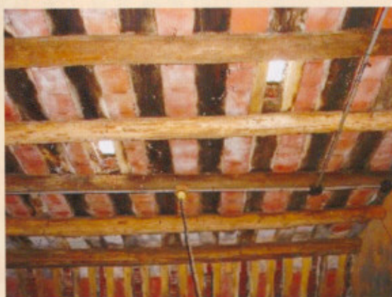
▲圖六十四：左內橫屋屋頂屋瓦缺漏情形
