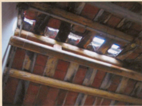
▲圖六十六：左內橫屋屋頂屋瓦缺漏情形
