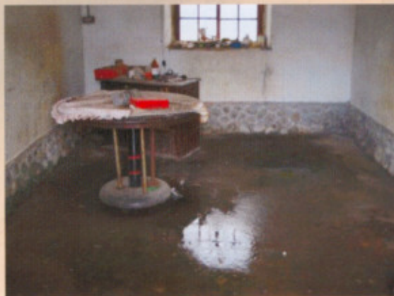
▲圖六十八：左內橫屋遇雨天屋頂漏水造成地面积水
