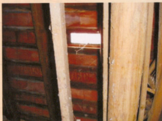
▲圖六十五：左內橫屋屋頂屋瓦缺漏情形
