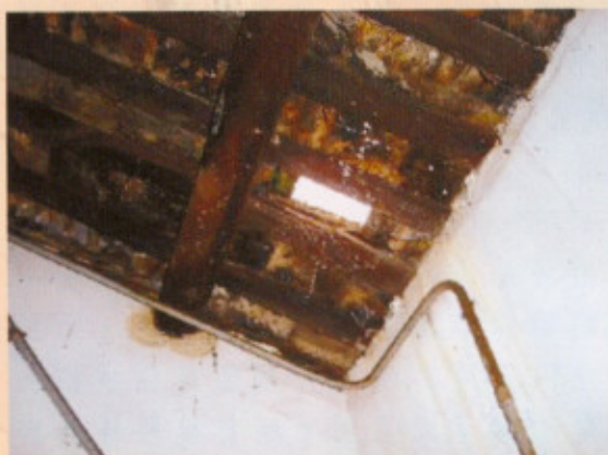
▲圖六十三：左內橫屋屋頂屋瓦缺漏情形
