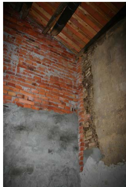
【圖 6-1-02】D9 山牆面已全部改為砌磚。
