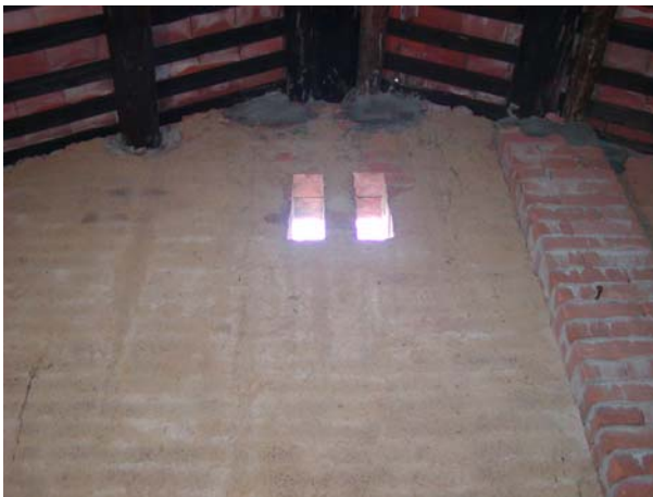
【圖 6-1-01】F4 牆面為較薄的土塊磚，加上磚柱。
