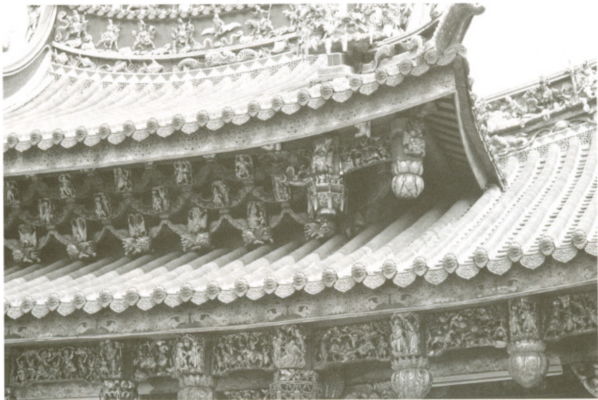
景福宮三川殿假四垂上下簷之間有三層網目斗栱及吊筒構造。康銘錫攝。
